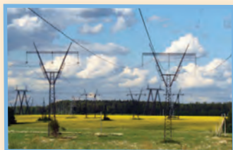
Las torres de alta tensión permiten la distribución de la energía eléctrica.
